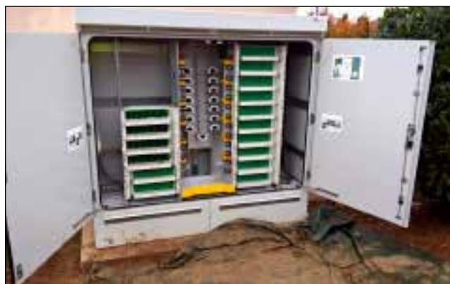
Armoire de connexion au réseau Fibre Optique à l'entrée du village.
